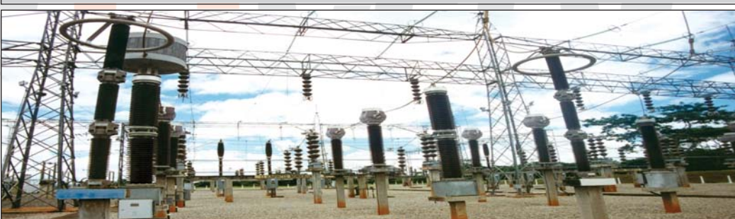
Foto Subestação Celg
