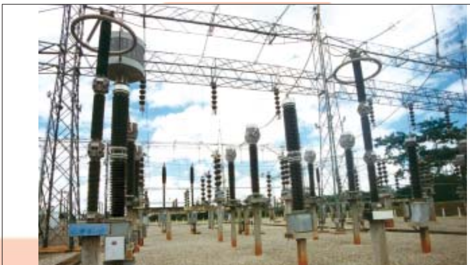
Foto Subestação Celg
